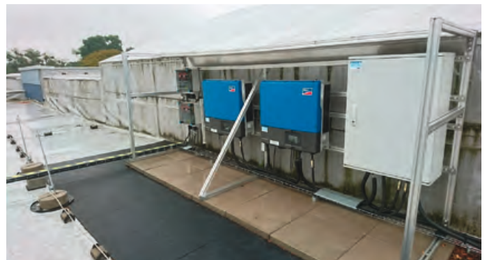
Photovoltaikanlagen mit Batteriebetrieb gibt es – nicht nur als Forschungsanlage – schon an der LUH, wie hier auf dem Dach des Zentrums für Hochschulsports. LUH for Future möchte gute bestehende PV-Lösungen auch zur Eigenstromversorgung an der Universität einsetzen und die PV-Nutzung ausweiten. Bild: Leibniz Universität Hannover
