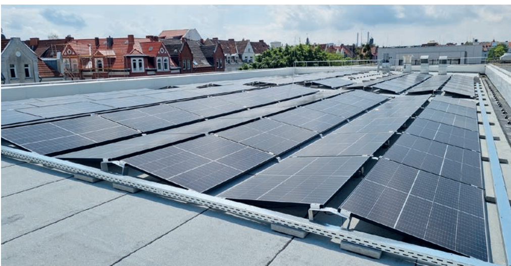
Photovoltaikanlage auf dem Dach des Gebäudes 3702 | ©LUH, Dezernat 3
