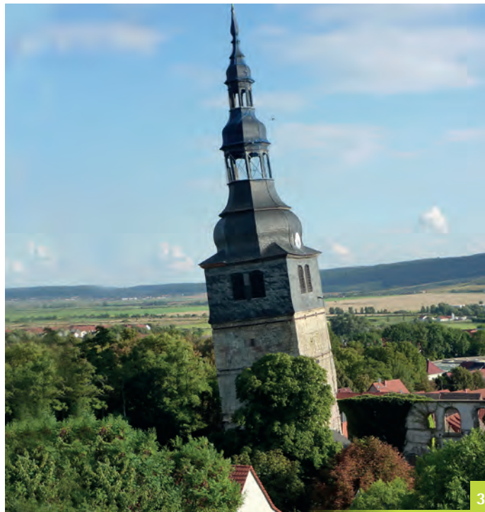
Abbildung 3 Folgen der Subrosionsprozesse in Bad Frankenhausen: Der Turm der Oberkirche, das Wahrzeichen der Stadt, weist aufgrund der Auslaugung des Untergrundes heute eine Neigung auf, die größer ist als die des Schiefen Turms in Pisa. Foto: LIAG
