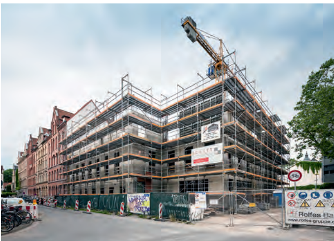
Neubau für die Leibniz School of Education und weitere Institute an der Straße Im Moore, Rohbau im Zustand von Juli 2021. Foto: Referat für Kommunikation und Marketing/LUH
