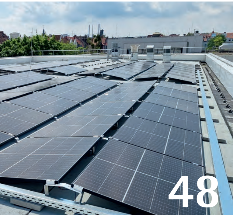
Photovoltaikanlage auf einem Universitätsgebäude: im Forschungsteil „Transformation der Energiesysteme“
